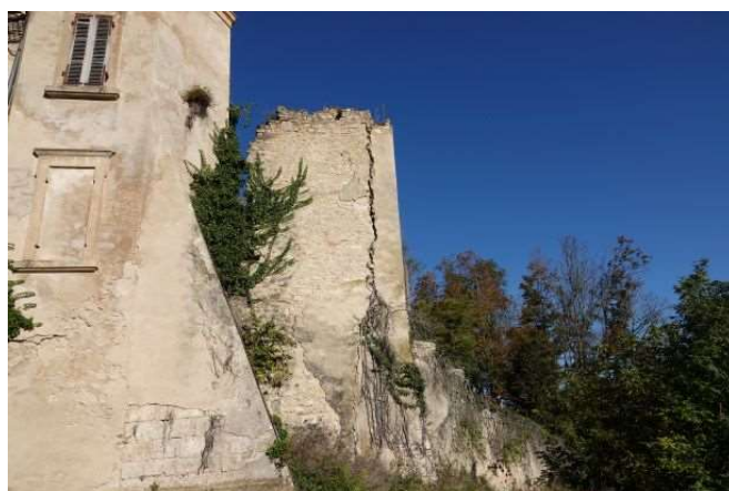
Tours E : contreforts et fissure tour carrée dont la profondeur est à vérifier
