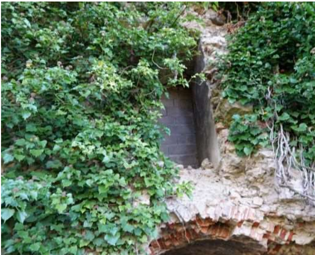
Parpaings en fond de brèche, de l'extérieur
