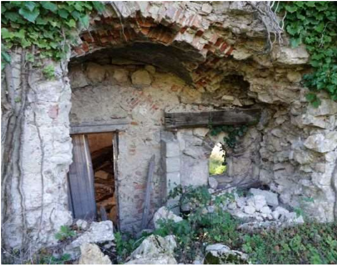
Ouverture en arcade, à la base de la brèche, vue de l'extérieur
